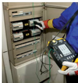
Mantenimiento terciario e industrial, diagnósticos y controles
